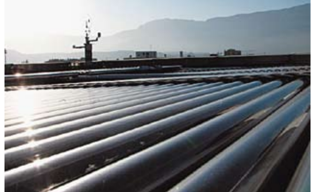
Blick auf die Sonnenkollektoren, welche auf dem EURAC-Gebäude installiert sind.
