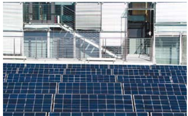
Photovoltaikanlage auf den Dachflächen der EURAC.
